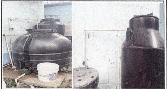
Foto 14: Red de agua potable en tinacos
