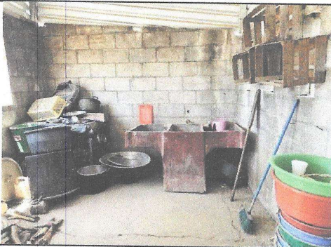
Foto 9: No se cuenta con piso en la cocina.
