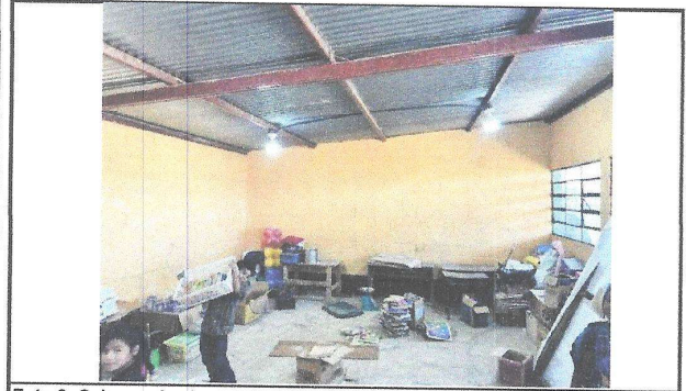
Foto 3: Salones de clases sin piso.
