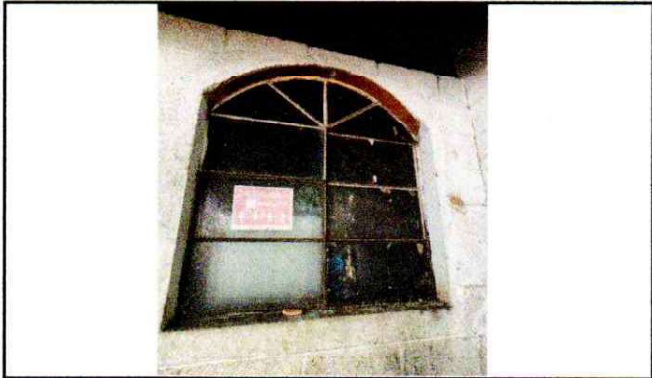
Foto 8: Módulo C, ventanas en mal estado
