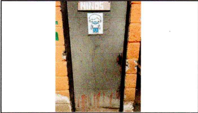
Foto 7: Módulo B, puertas en mal estado
