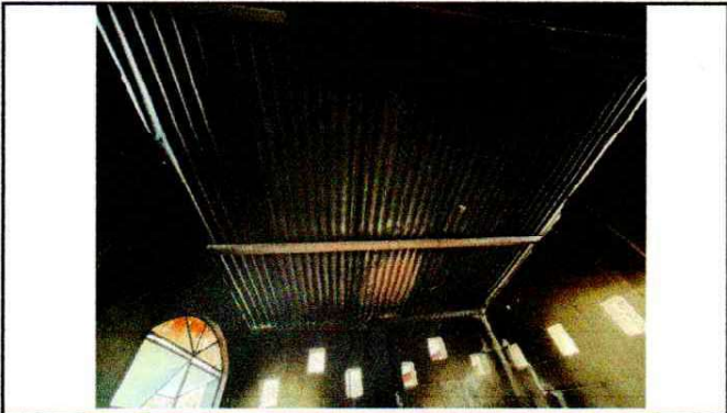
Foto 9: Módulo C, lámina en mal estado
