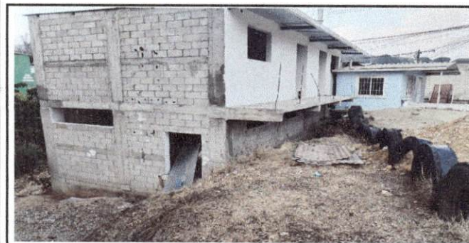
Foto 5 se necesita un pasamano y rampa en modulo 2y 3
