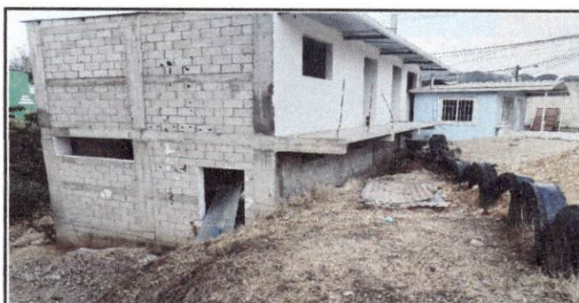
Foto 6 se necesita gradas en el modulo 1
