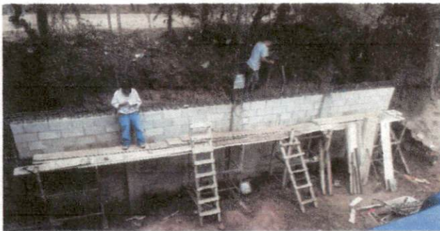
Foto 5: Llenado y compactación de tierra de tras del muro para darle el terminado requerido.
