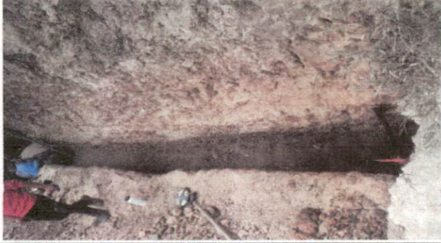
Foto 1: Zanjeado de la base para la colocación de zapata y columnas del muro de contención.
