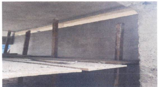
Foto 4: Continuidad en el trabajo de reparación de repello y cernido de paredes de la cocina.
