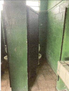
Foto 7: Módulo B, muros deteriorados
