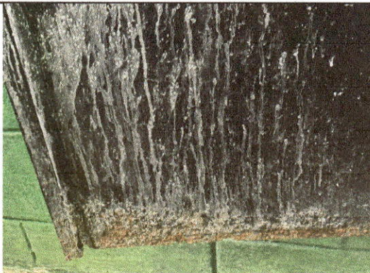
Foto 9: Módulo B, puertas deterioradas
