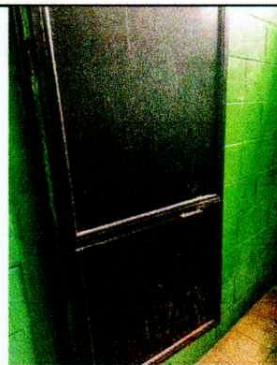
Foto 6: Módulo B, puertas en mal estado
