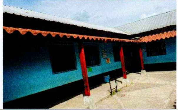
Foto 2: Módulo A, techo sin canal
