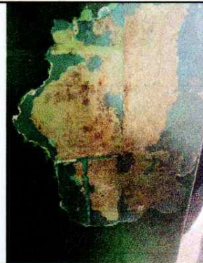
Foto 4: Módulo B, puertas en mal estado
