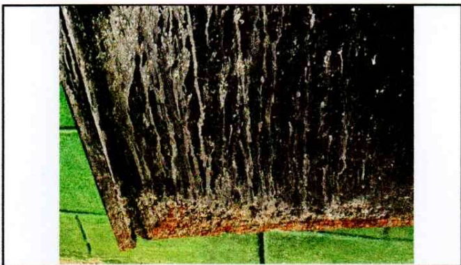
Foto 9: Módulo B, puertas deterioradas
