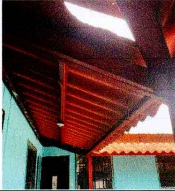
Foto 1: Módulo C, lámina en mal estado
