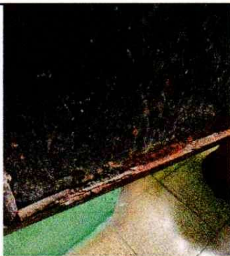
Foto 5: Módulo B, puerta con óxido
