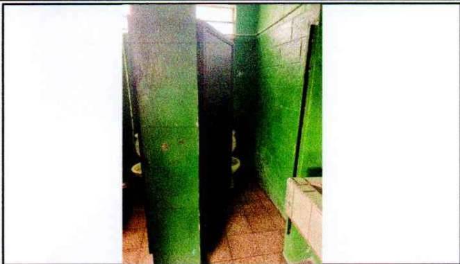
Foto 7: Módulo B, muros deteriorados
