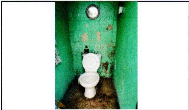
Foto 8: Módulo B, muros deteriorados
