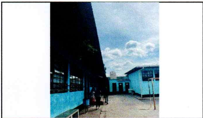
Foto 10: Módulo C, lámina deteriorada
