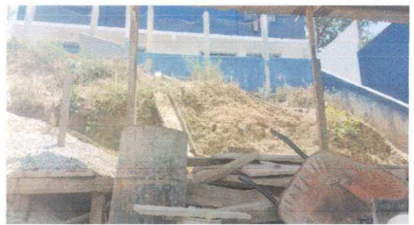
Foto 2: Muro de contención deteriorado, modulo 1 el cual sirve para delimitar el pasillo que conduce al modulo 2 que se encuentra en la parte baja del terreno.
