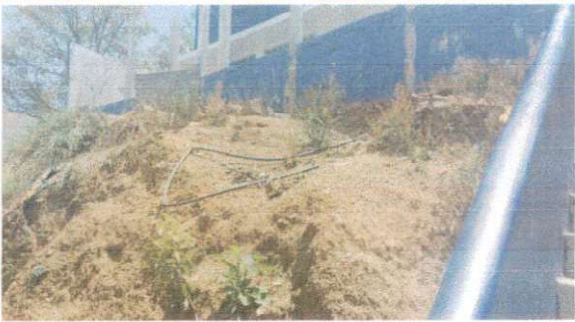
Foto 3: Muro de contención presenta rajaduras en varias partes. Por lo que se necesita su reparación.
