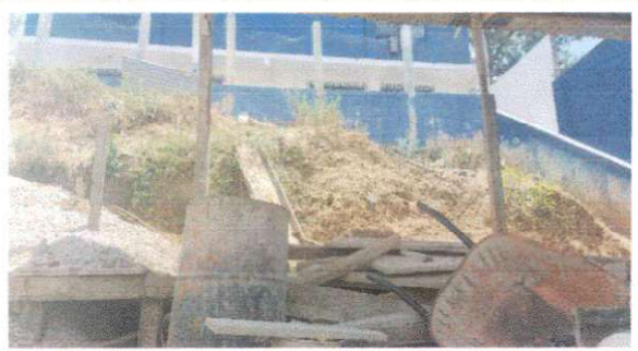
Foto 4: Mejoramiento de muro de contención modulo 1 que se encuentra agrietado en varias partes.
