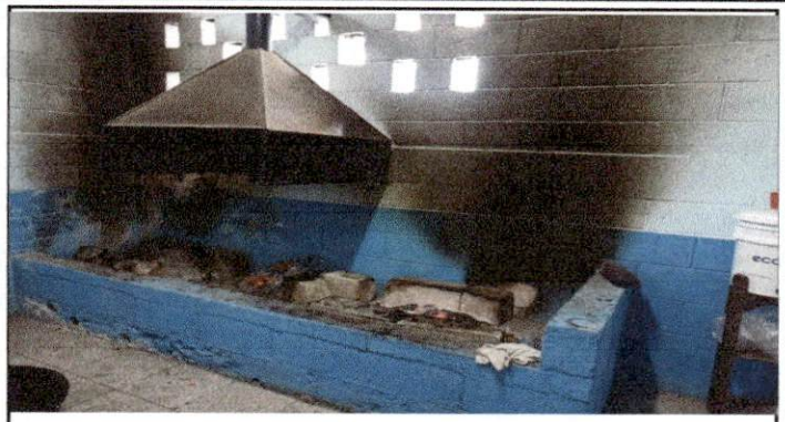
Foto 2: Esta es nuestra cocina en donde pero se puede observar que necesita modificación a la campana ya que cuesta que se balla el humo y se encierra.
