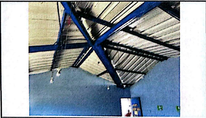
Foto 5: La instalación eléctrica de luz, se encuentra con problemas debido a que no se ha instalado de manera apropiada.
