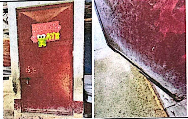
Foto 8: Es necesario realizar el mantenimiento de las puertas, ya que presentan problemas de corrosión.
