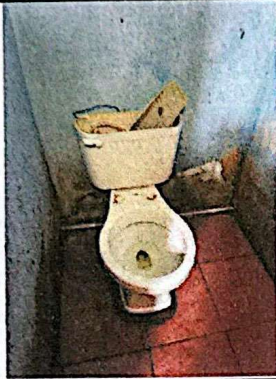
Foto 7: Los inodoros se encuentran en malas condiciones y no son funcionales actualmente.
