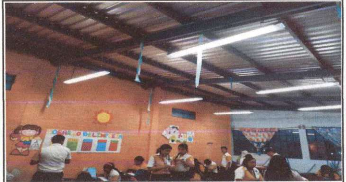
Foto 2: Revisión de circuitos de iluminación. Instalación de lamparas en seis salones de clases.
