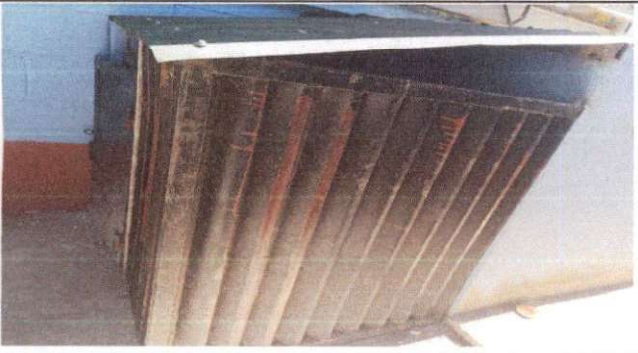
Foto 3: Techo para protección de bomba de agua.
