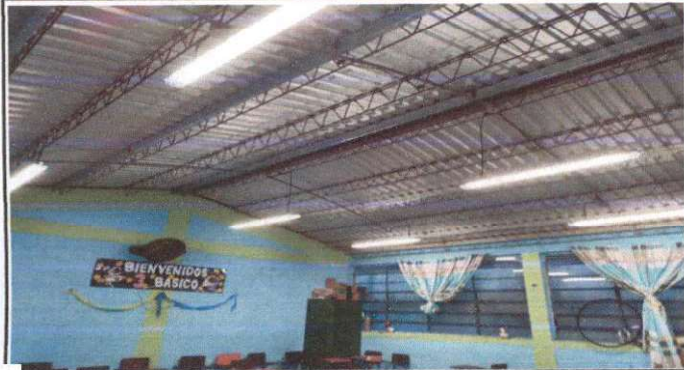
Foto 1: En aula cuarto "A" 2024, se cambiaron focos por lamparas led.
