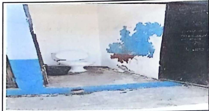
Foto 4: Imagen que muestra el área donde se realizará la sustitución de sanitarios infantiles.
