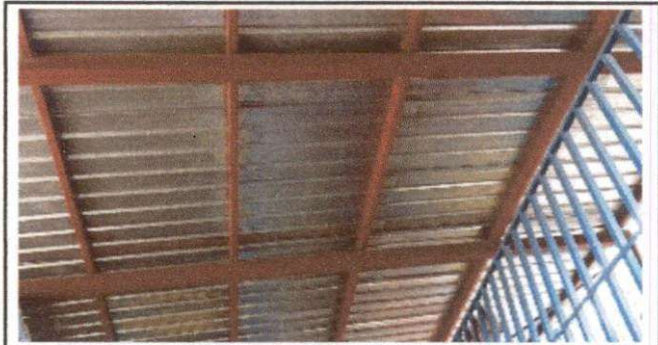
Foto 4: La estructura del techado presenta costaneras oxidadas en la parte interior.
