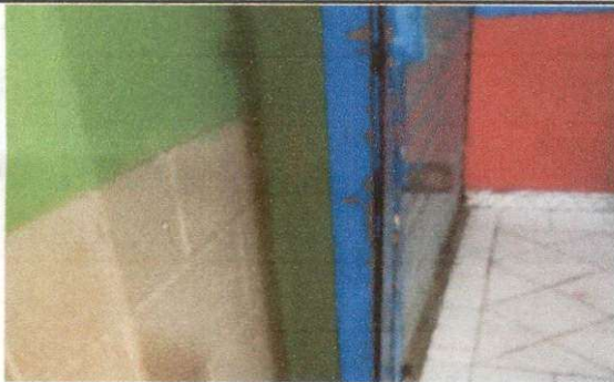
Foto 3: Las puertas de los salones están corroidas, presentan partes oxidadas y descoloridas. No se les ha dado mantenimiento en 25 años.
