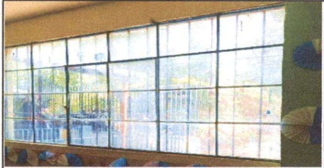
Foto 2: Las ventanas de los salones de clases están corroidas y los balcones en mal estado, por lo que su manipulación no es efectiva.
