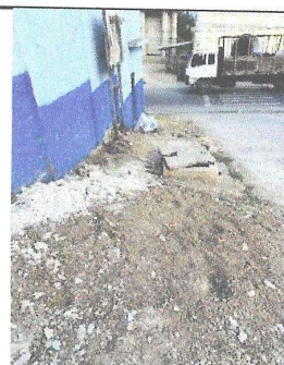
Foto 6: Se realizará la conexión de los drenajes de la cocina de manera directa al pozo de visita municipal.
