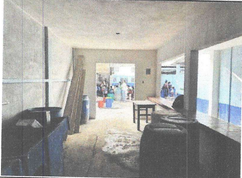
Foto 1: No se cuenta con instalación eléctrica tanto de luz como fuerza
