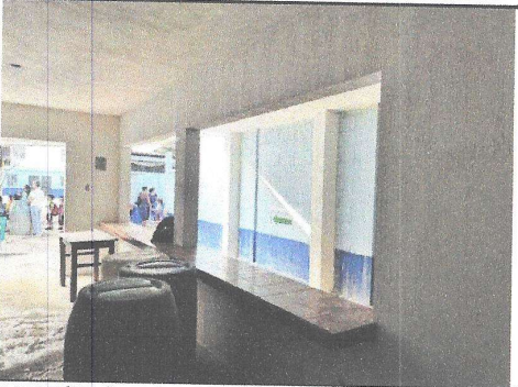
Foto 3: Se necesitan 2 persianas en el área de cocina
