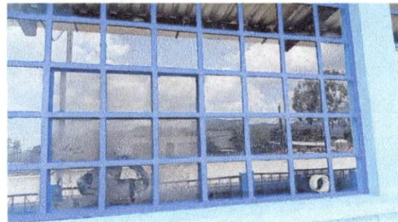
Foto 6: Pintura en ventanas.
