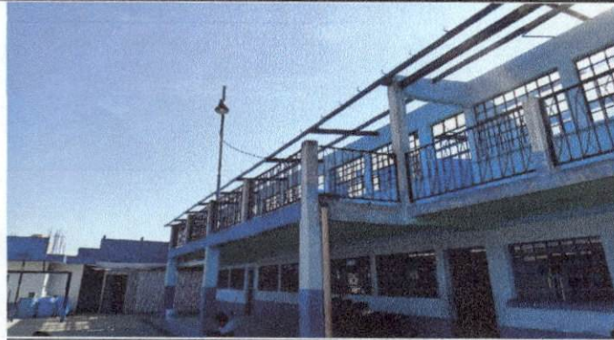
FOTO 1: EN ESTA FOTO ESTAN DANDO MANTENIMIENTO A LA ESTRUCTURA METALICA DEL TECHO DE 5 CINCON AULAS EN SEGUNDO NIVEL
