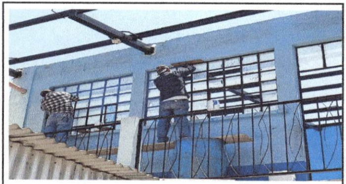
FOTO 4: DANDOLE MANTENIMIENTO A LA ESTRUCTURA METALICA DE LAS VENTANAS EN SEGUNDO NIVEL EN AULAS
