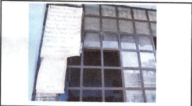
Foto 3: Situación actual de vidrios.
