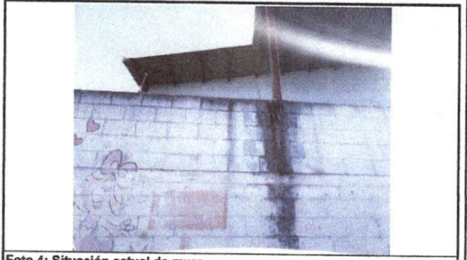
Foto 4: Situación actual de muro.
