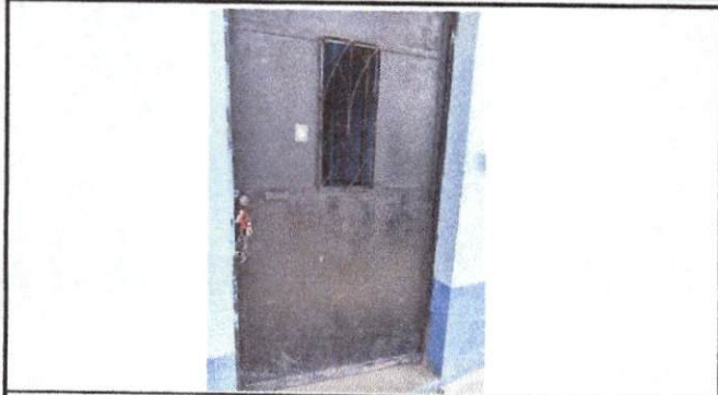
Foto 6: Situación actual de pintura en estructura metálica.
