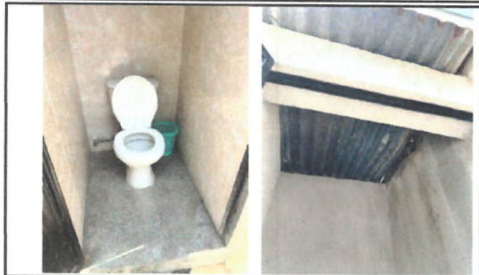
Foto 7: Baños con techo en malas condiciones, presenta problemas de filtración.
