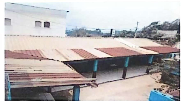
Foto 4: Derivado a la oxidación y filtración del agua del techo, es necesario el cambio de láminas troqueladas.
