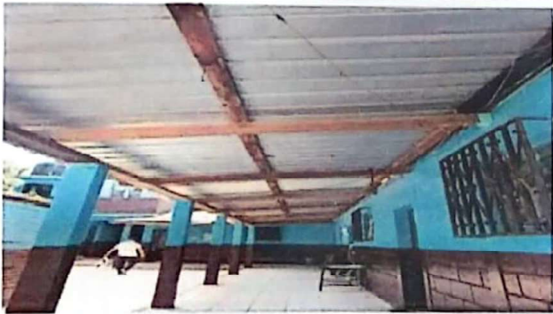
Foto 3: Derivado de una mala colocación de los balcones es necesario cambiarlas
