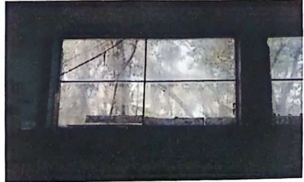
Foto 2: Todas las ventanas presentan deficiencias en su funcionamiento, impidiendo una ventilación adecuada. Lo cual es necesario la sustitución de la misma.
