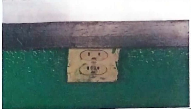
Foto 2: tomacorrientes en mal estado que será sustituido por una instalación nueva
