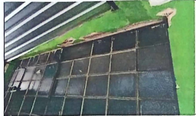
Foto 4: imagen del repello del exterior del salón 4 el cual será sustituido por repello nuevo
