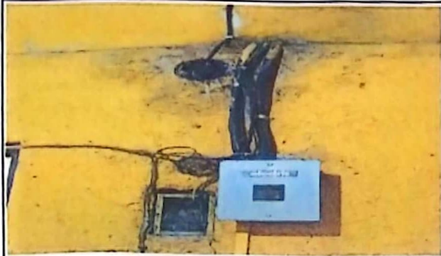
Foto 1: acometida del sistema eléctrico en mal estado el cual será sustituido por una acometida nueva.
