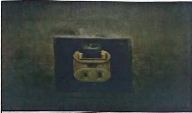
Foto 3: Parte de el sistema eléctrica en mal estado del salón 3 que estará siendo sustituido por una nueva instalación.
