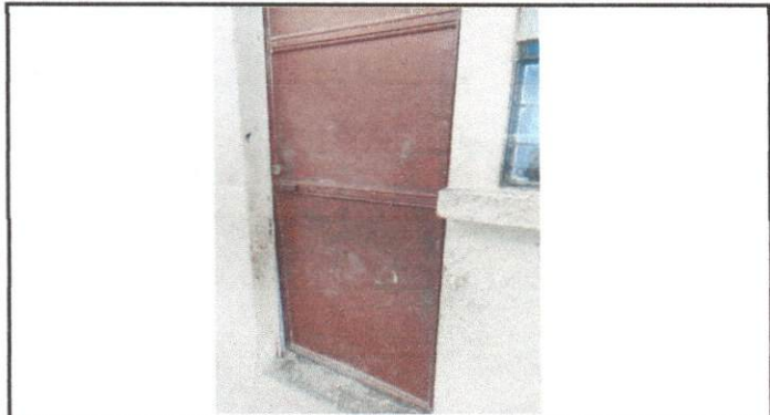
Foto 7: Puerta de aula desnivelada y deteriorada necesita ser reemplazada.
