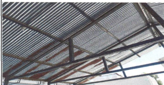
Foto 3: Falta de estructura metálica para que sirva de un mejor soporte y seguridad, ya que al momento no cumple con el mínimo de distancia entre estructuras.
