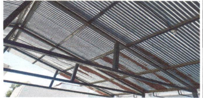
Foto 2: Patio de la planta alta techado, pero con evidente deterioro de lámina oxidada.
