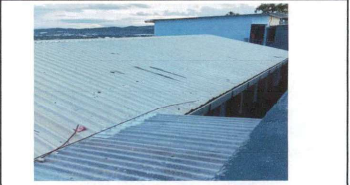
Foto 2: Se mantiene mucha humedad ya que el pasillo no tiene desembocadura de agua. Se quiere maximizar el espacio construyendo la loza en continuidad con el muro.
