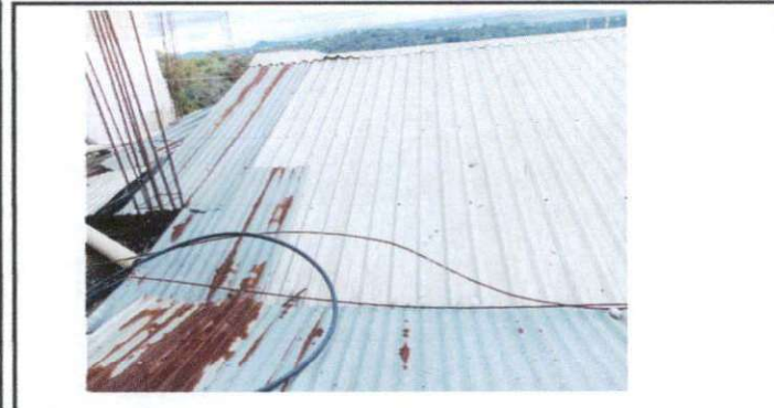
Foto 3: se encuentra una terraza de una bodega, se requiere dar la continuidad con los dos salones ya que la lamina contiene goteras y los alumnos se ven afectados.
