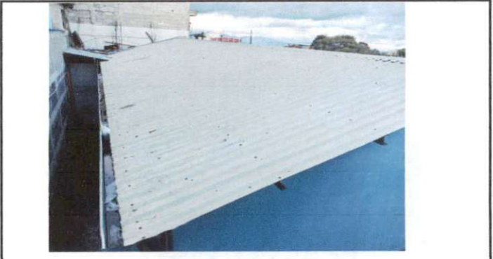
Foto 4: Se requiere cambiar toda la lamina
