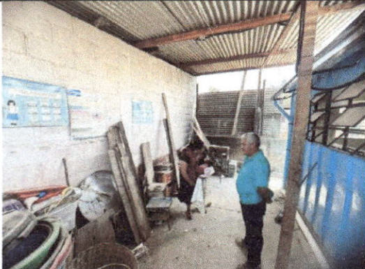
Foto 3: La cocina no cuenta con instalaciones apropiadas y dignas para realizar los alimentos, no cuenta con piso ni mesas de trabajo.
