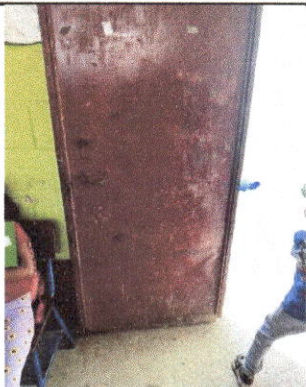
Foto 9: Las puertas se encuentran afectadas por el óxido, por lo que se deberá realizar el mantenimiento de las mismas, incluyendo el lijado y pintura de las mismas.
