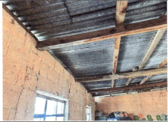
Foto 2: La estructura de madera presenta rupturas y empalmes por lo que se debe sustituir.
