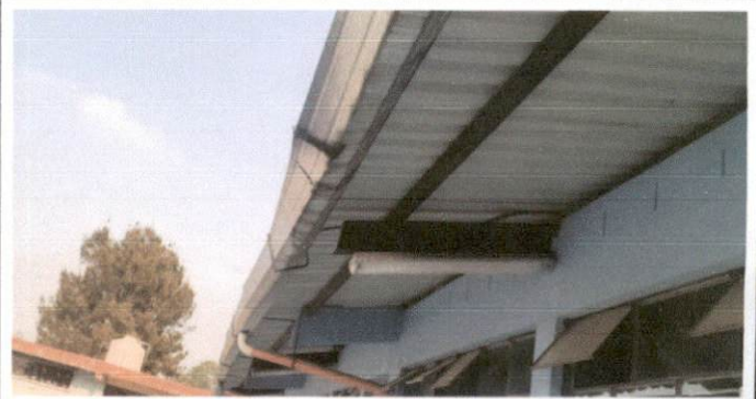
Foto 2: sustitución de canales del segundo nivel de las aulas, se encuentra en mal estado.
