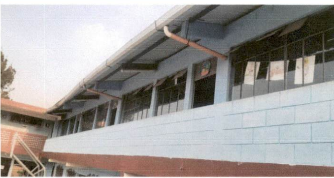
Foto 3: Remodelación de ventanales a corredizo para una ventilación agradable en los salones.
