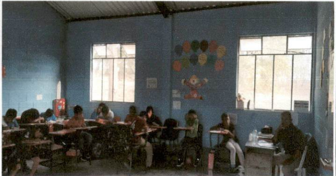
Foto 4: Mantenimiento del techo de lamina en los traslapes, en tiempo de lluvia gotea demasiado en los salones.
