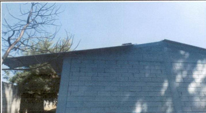
Foto 3: Reparación de techo por desprendimiento a raíz de los fuertes vientos
