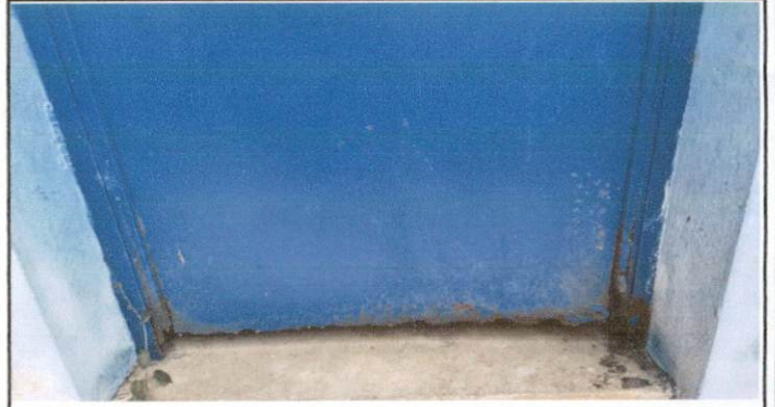
Foto 2: Mantenimiento de puertas por oxidación y sustitución de 2 puertas.
