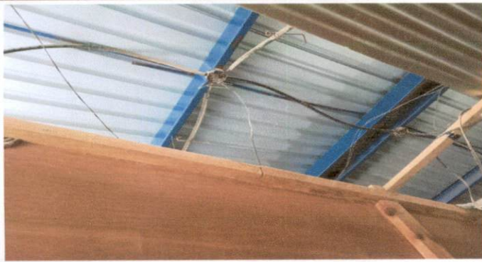
Foto 1: Cableado del sistema eléctrico tanto como tomacorrientes como los alumbrados, están en malas condiciones que ha sufrido de cortocircuito.
