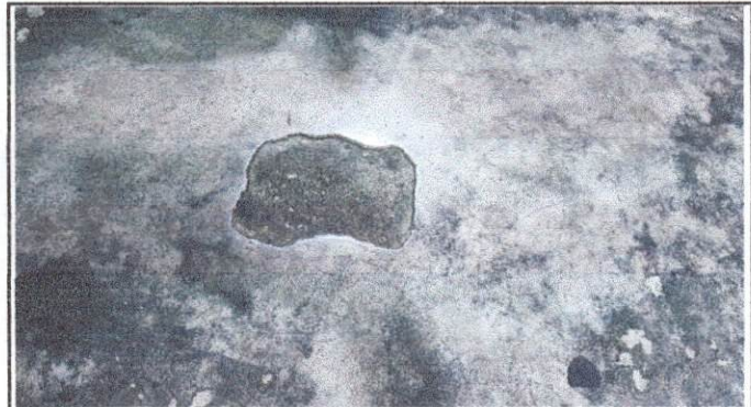
Foto 8 :Aula No. 8 Piso rustico de cemento con varios agujeros.
