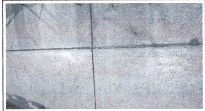
Foto 4: Aula No. 4 Piso rustico de cemento, planchas hundidas y desniveladas.
