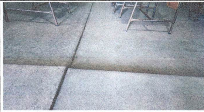
Foto 3: Aula No. 3 Piso rustico de cemento, planchas hundidas y desniveladas.
