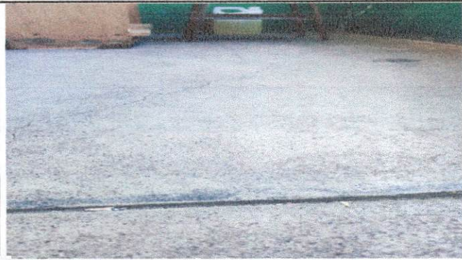
Foto 1: Aula No. 1 Piso rustico de cemento, planchas hundidas y desniveladas.
