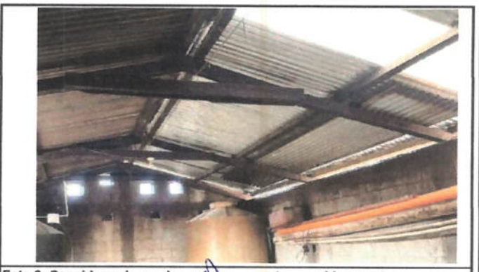
Foto 6: Considerando que la cocina no cuenta con chimenea la estructura del techo se encuentra ahumada por lo que se le deberá dar mantenimiento.
