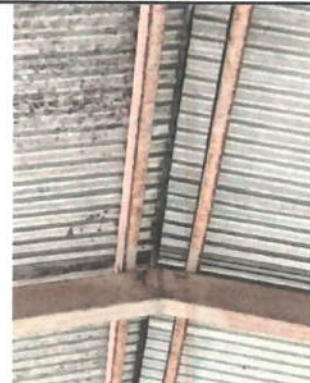
Foto 2: La estructura de techo, presenta oxidación.
