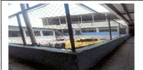
Foto 5: Estructura metalica a sustituir para la cubierta de lamina area de patio
