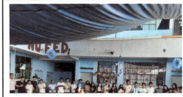
Foto 4: situación en la que se encuentra la cubierta de techo del patio, algunas partes con lonas y otras con cubierta de lamina en mal estado
