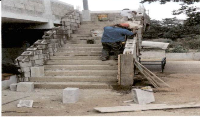
Foto1: Colocación de block y fundición de columnas para el pasamanos segundo nivel.
