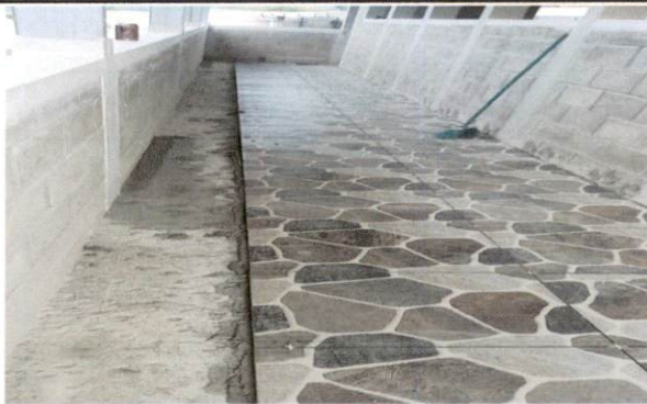
Foto 3: Instalación de piso cerámico rústico para el pasillo de los dos salones segundo nivel.
