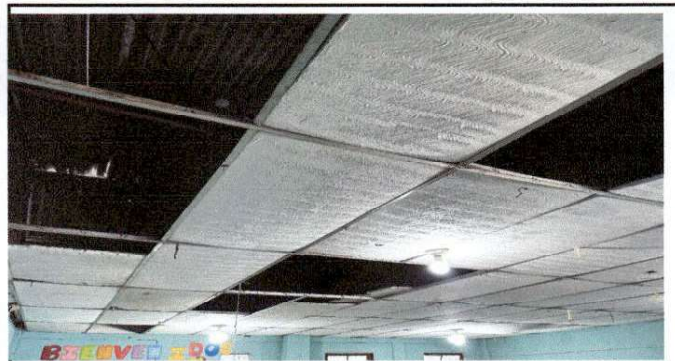
Foto 3: imagen que muestra la situación actual de techo y cielo falso del aula de proyecto de cambio de lamina por techo de losa.
