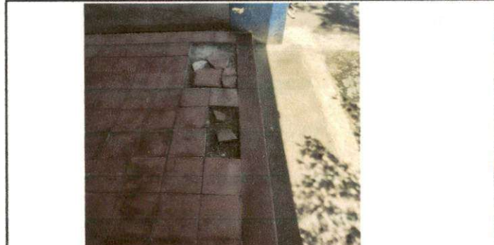
Foto 6: Piso dañado, corredores modulo 1.
