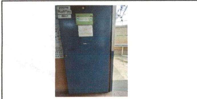
Foto 5: Puertas necesitan mantenimiento.
