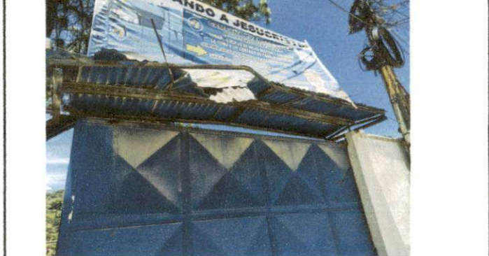
Foto 2: Porton, guias, rodos y techo dañados.
