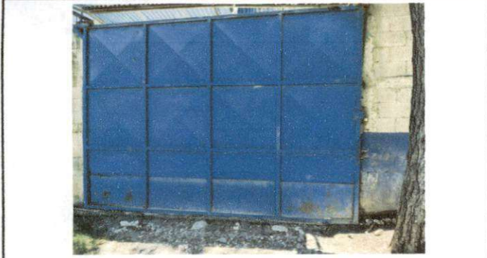
Foto 1: Porton paneles inferiores podridos y rieles. Se fabricara puerta de paso.
