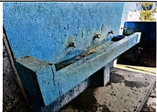
Foto 6: Lavamanos tipo pileta, el cuál se deberá forrar con azulejo.
