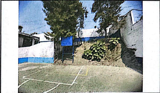
Foto 8: En este punto se deberá realizar un muro de contención de 1 metro de altura, para evitar que la tierra que se desprende se riegue en la cancha.
