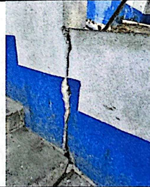
Foto 4: Fisuras en muro que delimita el módulo de gradas, el cuál se encuentra a punto de colapsar.
