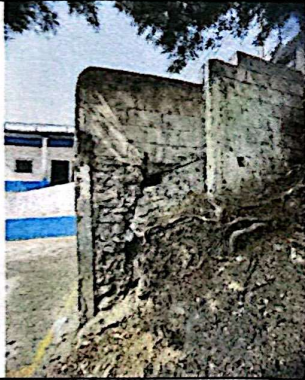
Foto 3: El muro de contención de las gradas se encuentra fuertemente afectado por lo que es un riesgo para los estudiantes.
