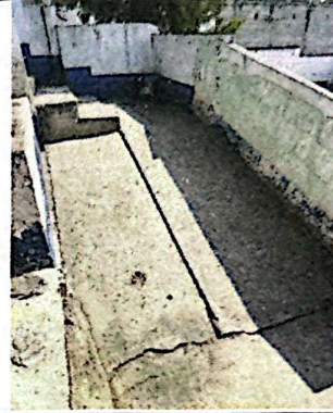
Foto 2: Se pueden apreciar las fisuras en la rampa de acceso.
