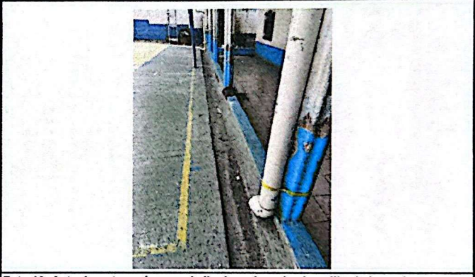
Foto 10: Actualmente en épocas de lluvia se inunda el pasillo de los salones debido a que no es suficiente el canal que se tiene, por lo que se deberá fabricar una cuneta, con su respectiva rejilla.
