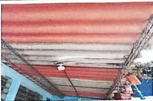
Foto No 5 Esta imagen muestra el deterioro de la lámina de duralita del salón No. 1
