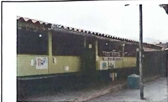
Foto No. 4 Esta imagen muestra el frente de los 2 salones a los cuales se les cambiará la lámina de duralita por lámina troquelada. Los cuales se ubican frente al patio del establecimiento
