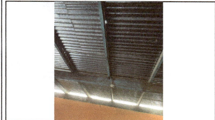
Foto 9: Módulo A, lámina, estructura portante y luminaria en mal estado
