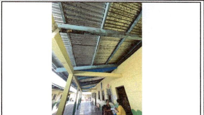
Foto 8: Módulo A, lámina en mal estado
