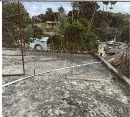
Foto 10: Módulo A, losa deteriorada
