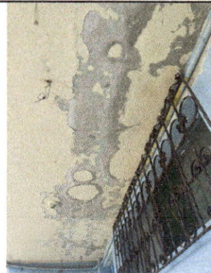
Foto 2: Módulo A, techo deteriorado
