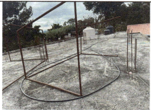
Foto 4: Módulo A, losa en mal estado
