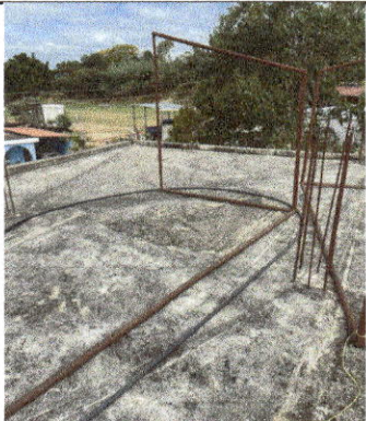
Foto 9: Módulo A, losa en mal estado
