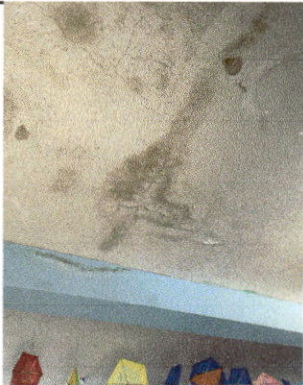
Foto 3: Módulo A, techo en mal estado
