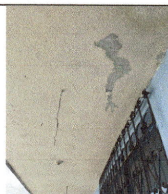
Foto 6: Módulo A, techo en mal estado
