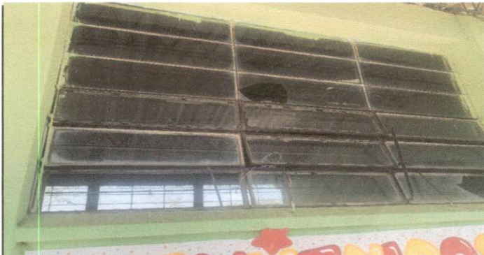
Foto 6: Aproximadamente 100 vidrios quebrados.
