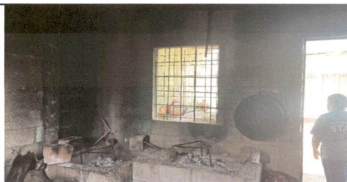
Foto 5: cocina en mal estado.
