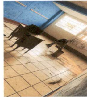
Foto 4: imagen que muestra el area de salon 4 donde se instalando el piso de cerámico del modulo 1
