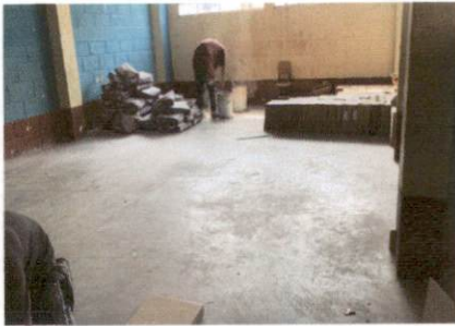
Foto 2: imagen que muestra el area de salon 3 donde se instalando el piso de cerámico del modulo 1
