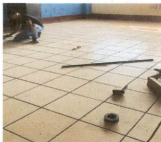
Foto 9: imagen que muestra el area de solon 9 donde se instalando el piso de cerámico del modulo 2
