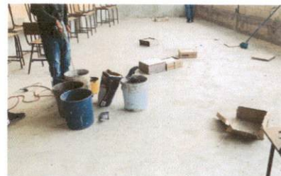
Foto 8: imagen que muestra el area de solon 8 donde se instalando el piso de cerámico del modulo 2
