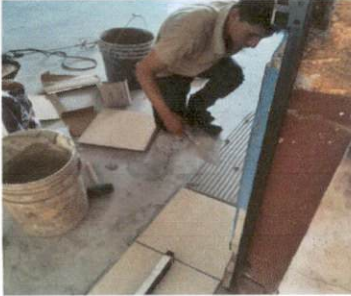
Foto 1: imagen que muestra el area de salon 2 donde se instalando el piso rámico del modulo 1
