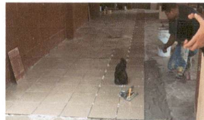
Foto 10: imagen que muestra el area de solon 10 donde se instalando el piso de cerámico del modulo 2
