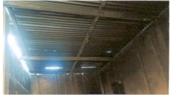
Foto 7: imagen que muestra el estado actual de la lámina galvanizada del modulo 1.
