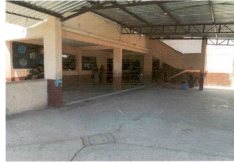
Foto 2: imagen que muestra el area de corredor donde se va sustituir e piso de concreto por piso de cerámico.
