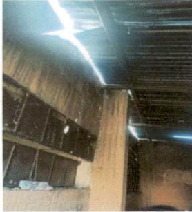
Foto 7: imagen que muestra el estado actual de la lámina galvanizada del modulo 1.
