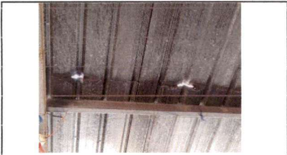
Foto 3: Foto interna de las láminas en mal estado del módulo 1.
