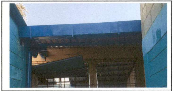
Foto 6: Estructura y canal que conducirá el agua a través de un nuevo conducto, evitando el agua en los salones
