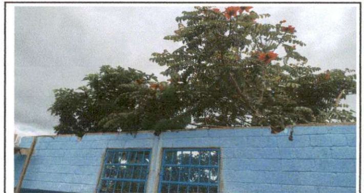
Foto 4: Tercer salón sin estructura y techo previo a la colocación de la nueva estructura y lámina
