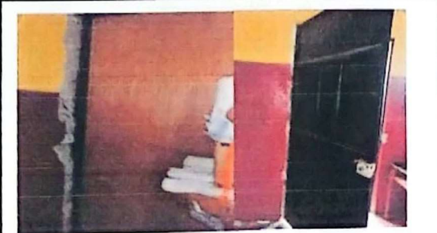
Foto 5: algunas puertas se encuentran muy deterioradas, por lo cual necesitan ser cambiadas. Y algunas necesitan cambio de pintura, chapas o correlativo.
