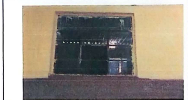
Foto 6: algunas ventanas no cuentan con vidrios y balcones en buenas condiciones, por lo cual es necesario, sustituir vidrios y colocar balcones.
