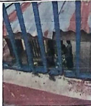
Foto 8: Las barandas que circulan el patio del Establecimiento se encuentran en total deterioro (oxidado) motivo por el cual necesitan ser renovadas.
