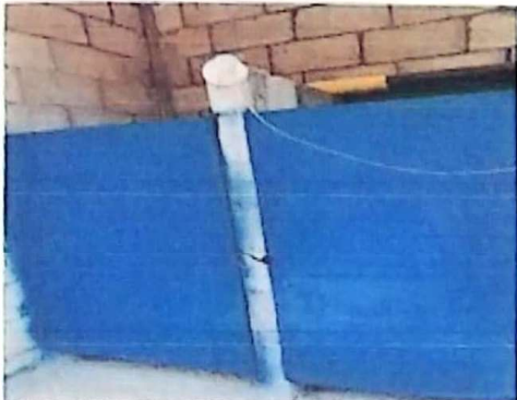
Foto 8: el área de sanitario presenta poca iluminación razón por el cual se necesita una nueva instalación eléctrica en el alumbrado.
