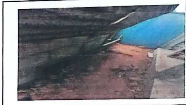
Foto 4: El muro perimetral que circula los sanitarios esta totalmente por colapsar, por lo que se necesita una nueva reparacion.
