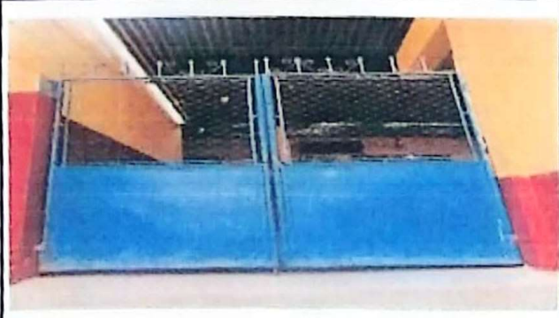
Foto 1: los portones de entrada y acceso al sanitario de la EORM El Pilar II, se encuentran en mal estado, por lo cual es necesario sustituirlos.
