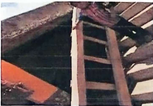
Foto 7: El pasamanos, que conduce hacia los sanitarios, se encuentra en mal estado motivo por el cual necesita remozarlo.
