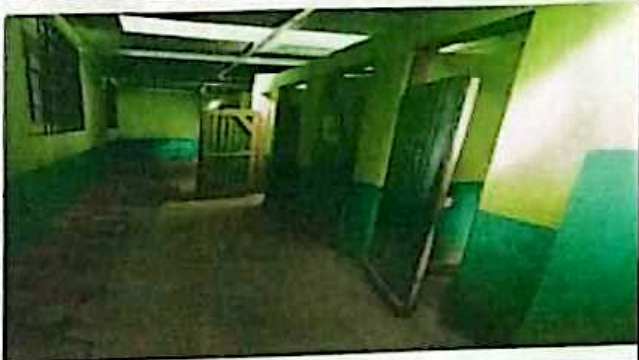
Foto 3: Imagen del pasillo de los sanitarios donde se observa el piso deteriorado el cual será sustituido por piso antideslizante.
