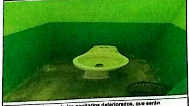
Foto 2: Imagen de uno de los sanitarios deteriorados, que serán sustituidos por sanitarios nuevos, cambio de piso y reparación de las paredes.
