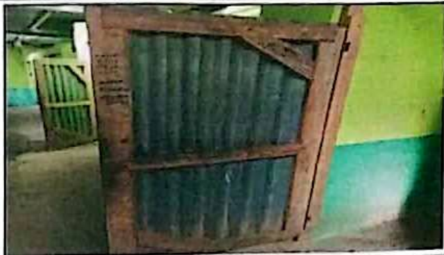
Foto 1: Imagen de la puerta de uno de los sanitarios de las niñas hecha de lámina los cuales serán sustituidos por puertas de metal
