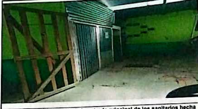
Foto 4: Imagen de la puerta de la entrada principal de los sanitarios hecha de madera que será sustituida por una puerta de metal.
