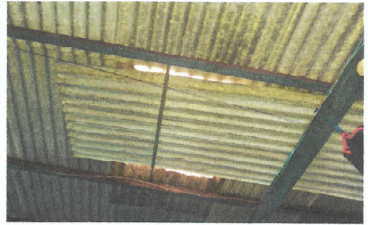
Foto 2: Área de la bodega que necesita sustitución de techado
