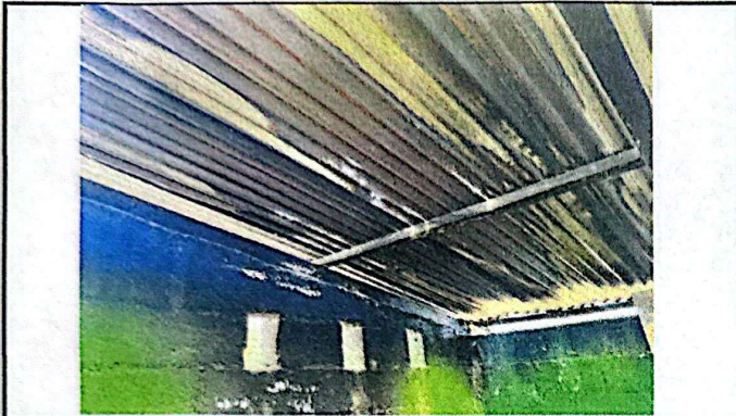
Foto 7: Se puede apreciar el deterioro en el techo de la cocina, por lo que es indispensable realizar el cambio del mismo.
