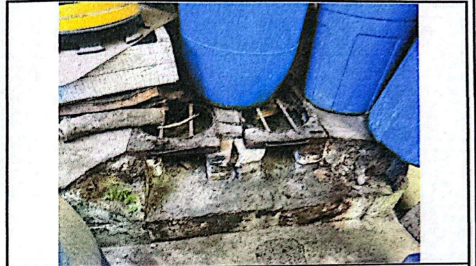
Foto 8: La actual plancha para la preparación de los alimentos se encuentra fuera de servicio y se deberá construir una nueva.
