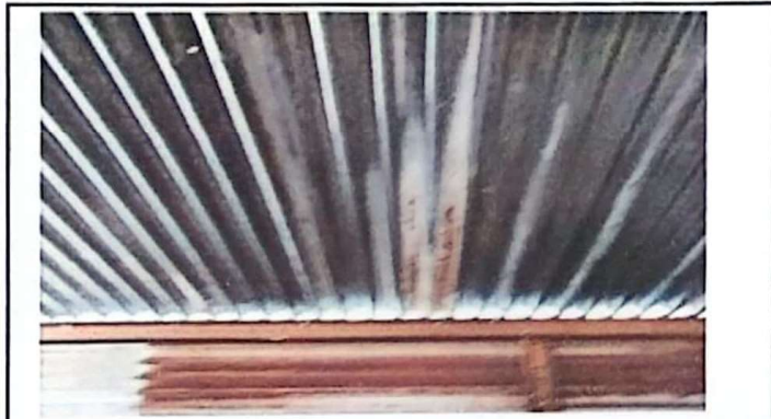
Foto 3: En muchas ocasiones se ha sufrido cuando llueve y empieza a gotiar, de tal forma se considera oportuno sustituir este techo para evitar las inconvenientes que puede ocasionar nuevamente la época lluviosa.
