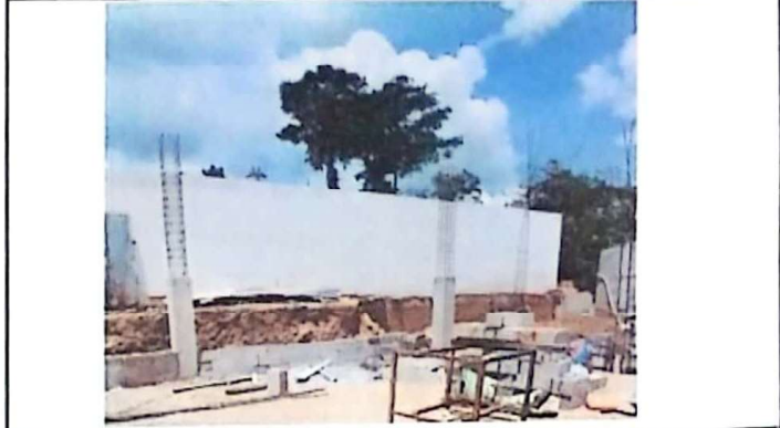
Foto 2: para ingresar al area de cocina se necesita construir una rampa, de tal forma es importante continuar con la construcción de la pared, de esa forma se evita accidentes.
