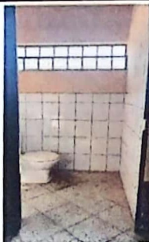
FOTO 5: Imagen que muestra el área donde se demolerá muro y se ampliará puerta para área de cocina.
