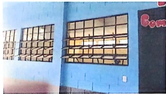
FOTO 6: Imagen que muestra el estado actual del área donde se realizará la colocación de balcones.
