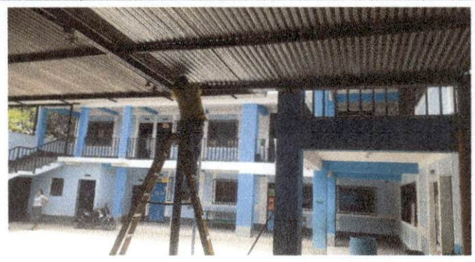
Foto 2. La instalación eléctrica que esta en el escenario del patio.
